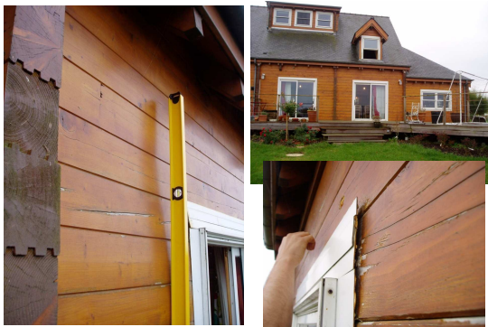
Conséquences dommageables: variations de teneur en eau sous charge
