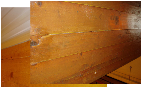
Fissures et délaminations: bois lamellé collé
