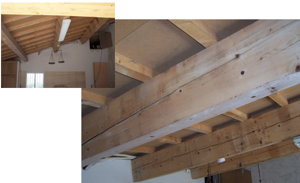
Fissures en intérieur: Bois massif résineux
