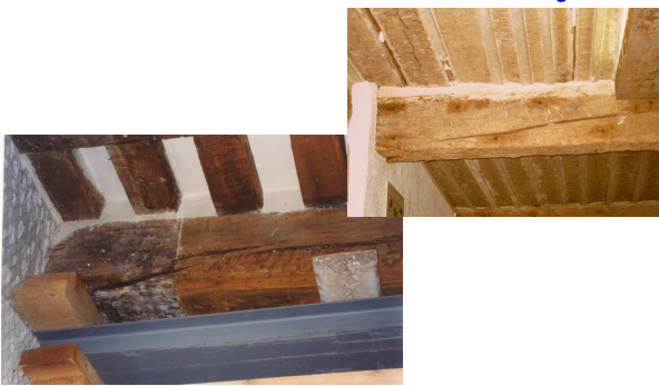
Interaction cisaillement / fissures de séchage
