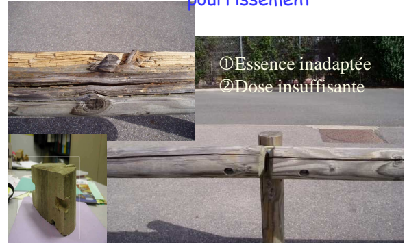
Durabilité (conférée) insuffisante: pourrissement
